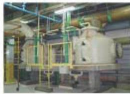
Equipos de vacío
