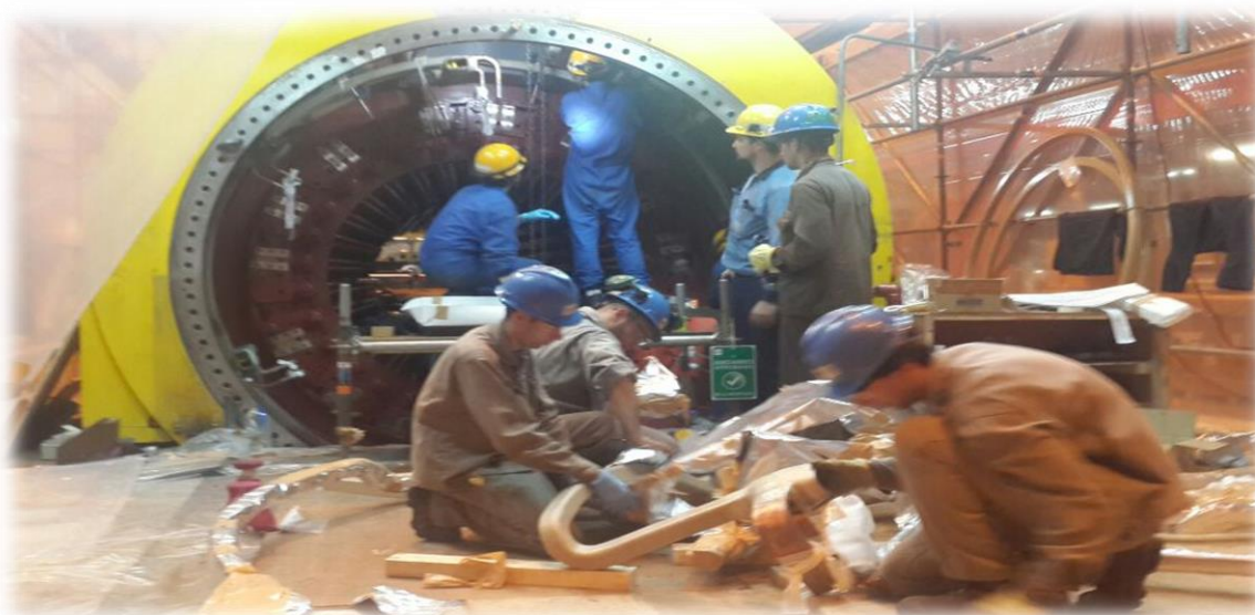
Generador Unidad 10 Mitsubishi- ciclo combinado (turbina a vapor)
